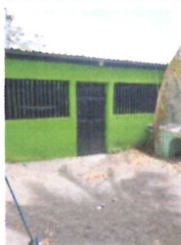
PUERTA, SUSTITUCION DE PUERTA DE COCINA EN MAL ESTADO
